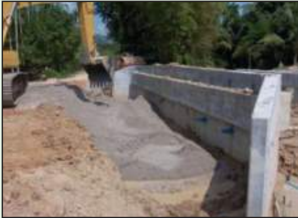
รูปที่ 4-20 การถมดินบริเวณข้างท่อ หรือโครงสร้างระบายน้ำ
