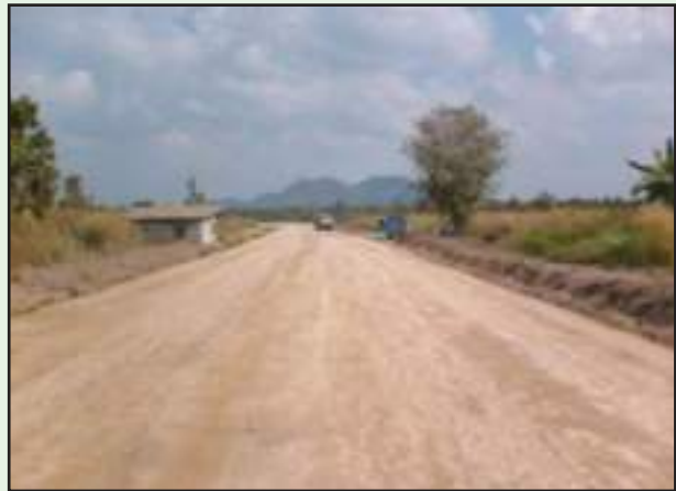
รูปที่ 4-32 งานก่อสร้างแล้วเสร็จจะต้องมีระดับความกว้าง ความยาวและความแน่นตามแบบแปลน
