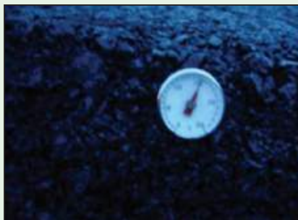
รูปที่ 6-28 ตรวจเช็คอุณหภูมิก่อนใช้งานและขณะปูลงบนพื้นทางต้องอยู่ในช่วง 120 - 150^{\circ}\text{C}
