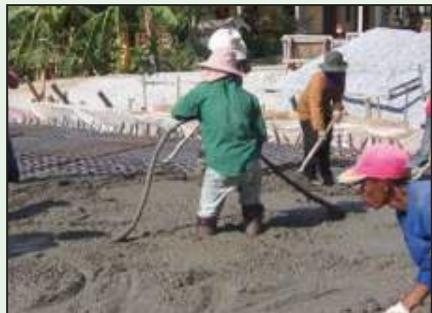
รูปที่ 5-28 (ข) การจี้คอนกรีตขณะเทคอนกรีต
