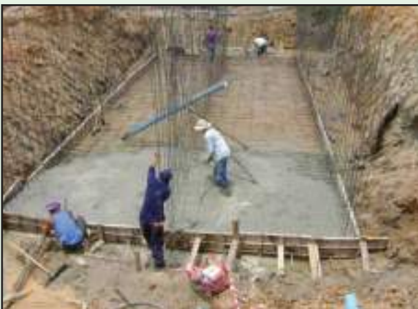
รูปที่ 5-28 (ก) การจี้คอนกรีตขณะเทคอนกรีต
